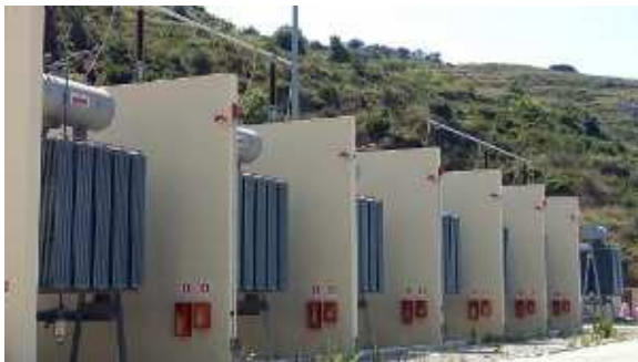
Visuale di insieme dei dispositivi antincendio installati in prossimità dei reattori presso stazione di Villafranca
