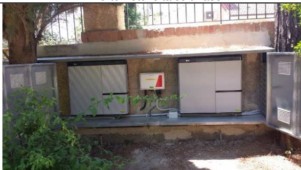
Batterie di accumulo e dispositivo di interfaccia batterie
