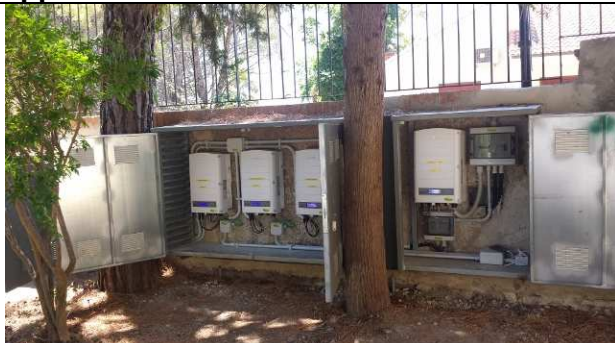
Visione di insieme inverter
