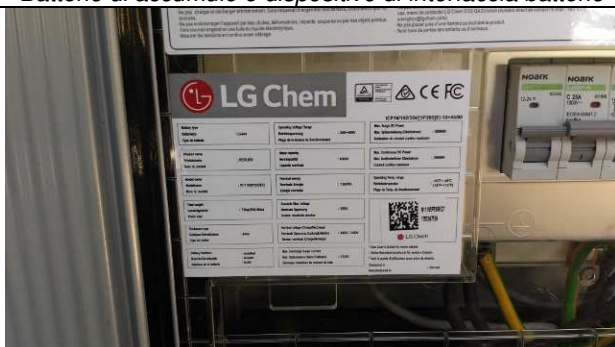
Targa batteria di accumulo
