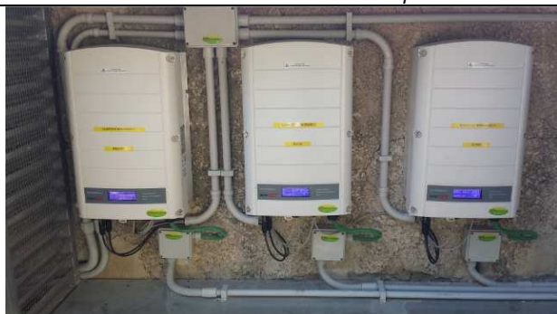
Inverter monofase di interfaccia con le batterie
