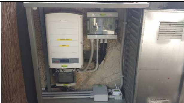
Inverter fotovoltaico trifase
