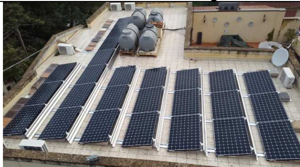
Visione di insieme moduli fotovoltaici
