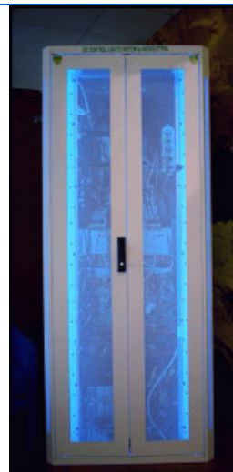
Figura 1 - Sistema in condizioni ottimali con rack a porte chiuse
